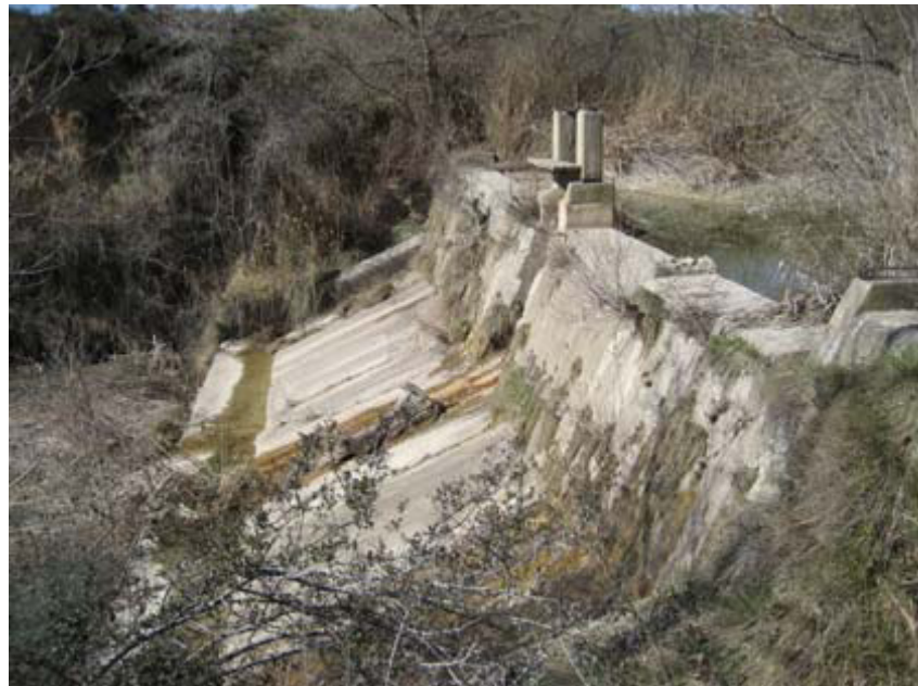
Vista general del azud de Igríés, situado aguas arriba de dicha localidad, dónde nace la acequia de riego más importante del río Isuela.
