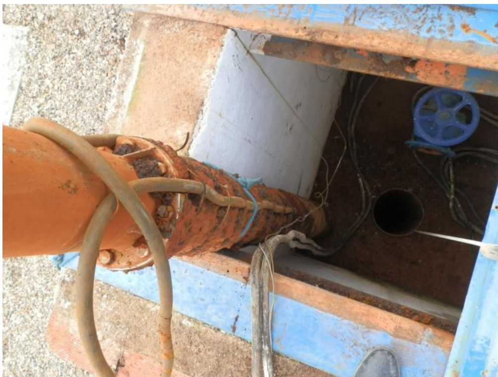
Foto 2. Pozo 1 de Mora d'Ebre (observación)
