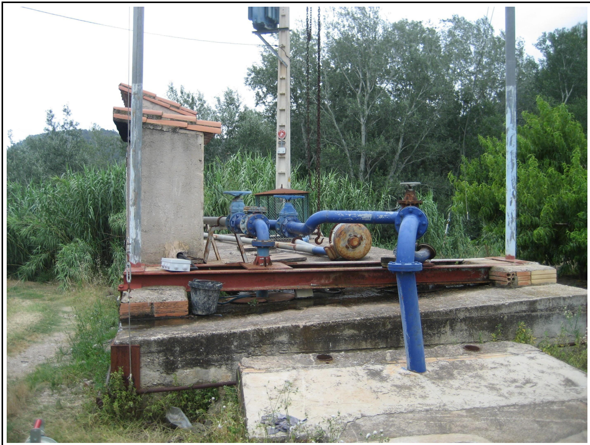
Depósito regulador y bombeo de los pozos LLigem (08/07/2008)
