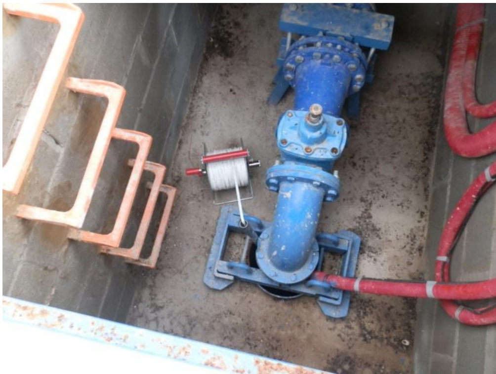
Foto 1. Pozo 2 de Mora d'Ebre (bombeo). Tubería piezométrica para medida de nivel
