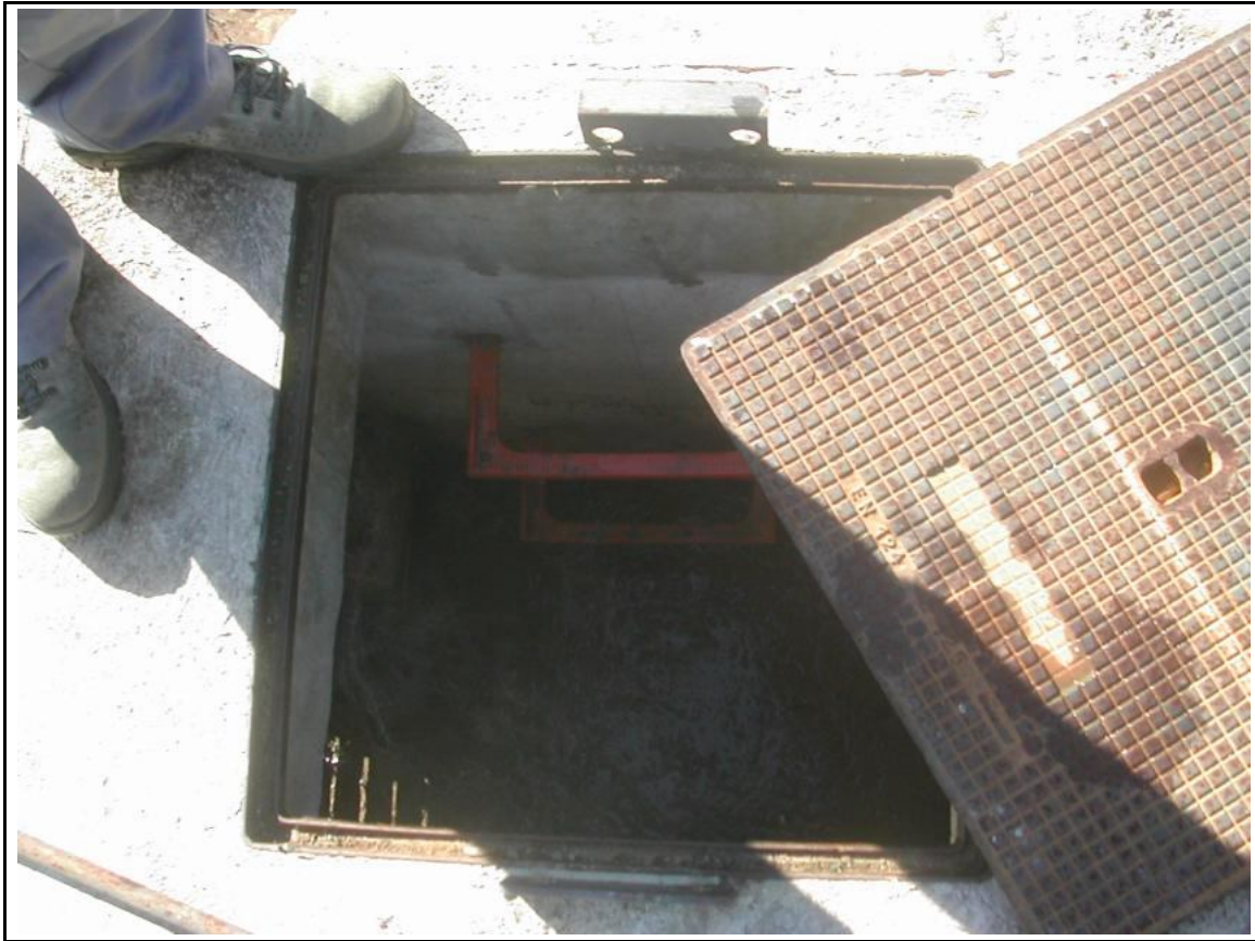
Arqueta de captación (14/11/2006)
