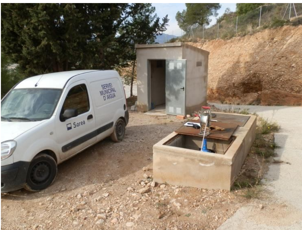
Foto 2. Detalle pozo abastecimiento Tivenys
