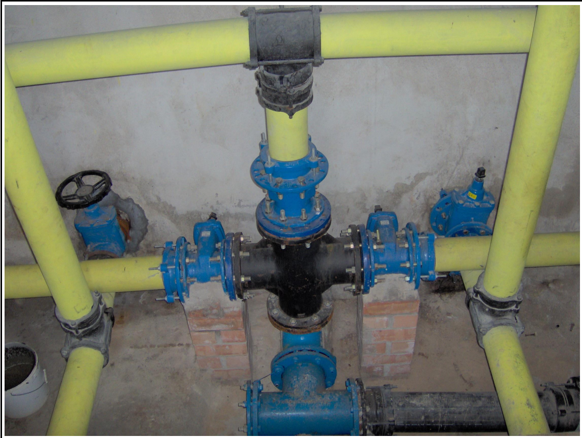
Tuberías que comunican los dos depósitos (16/11/2006)
