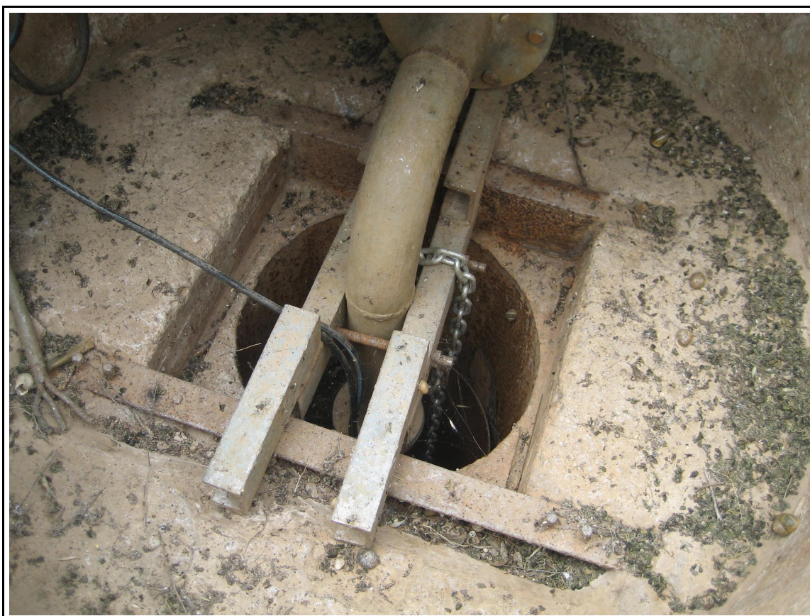
Vista detalle del pozo LLigem 1 (08/07/2008)
