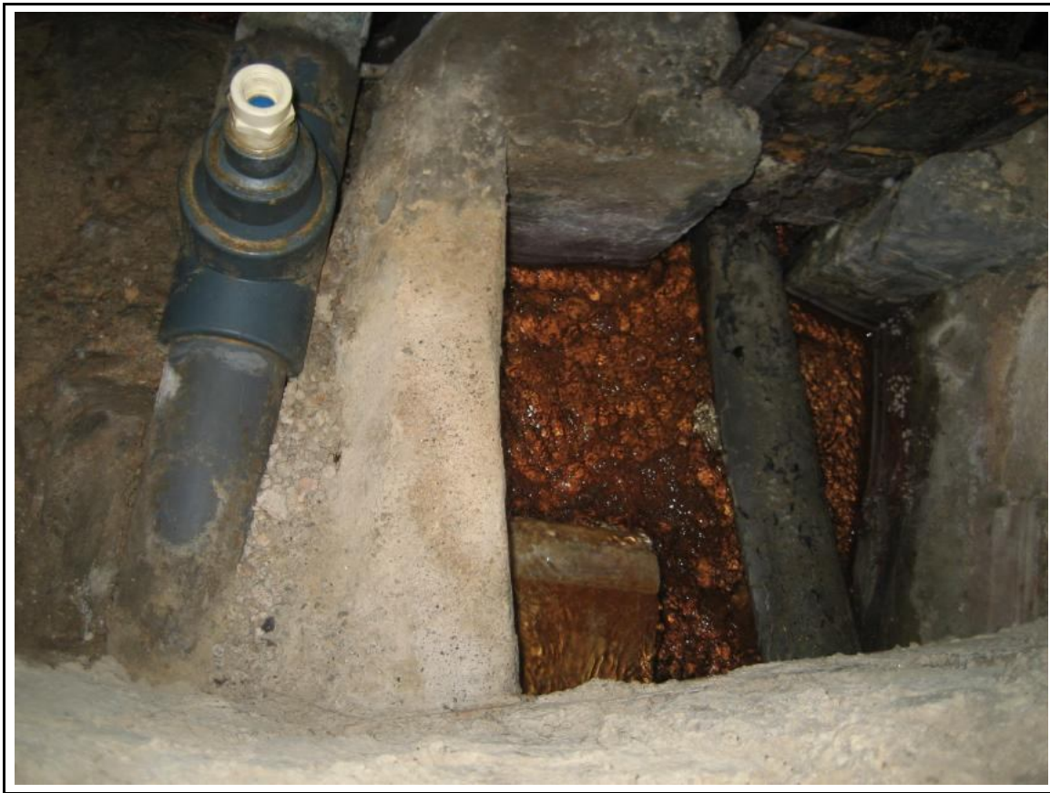
Agua del pozo surgente que rellena la balsa - depósito (08/07/2008)
