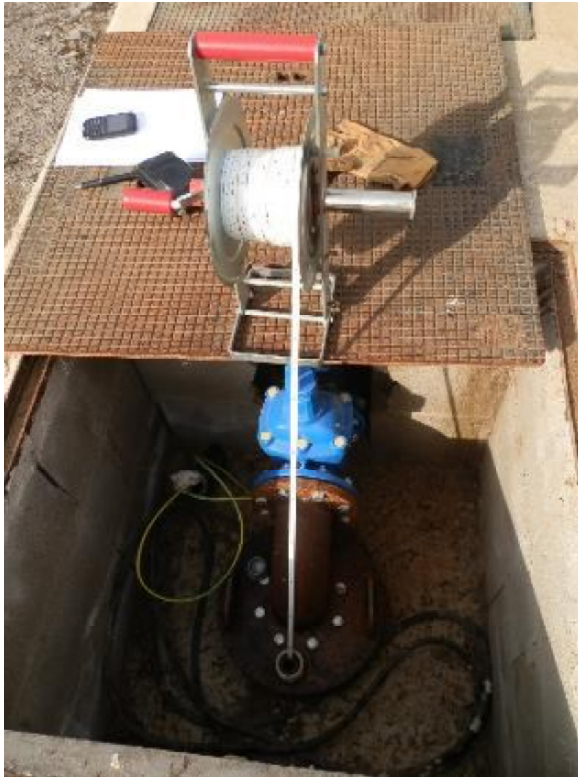
Foto 5. Medida de niveles en pozo de abastecimiento a Tivenys
