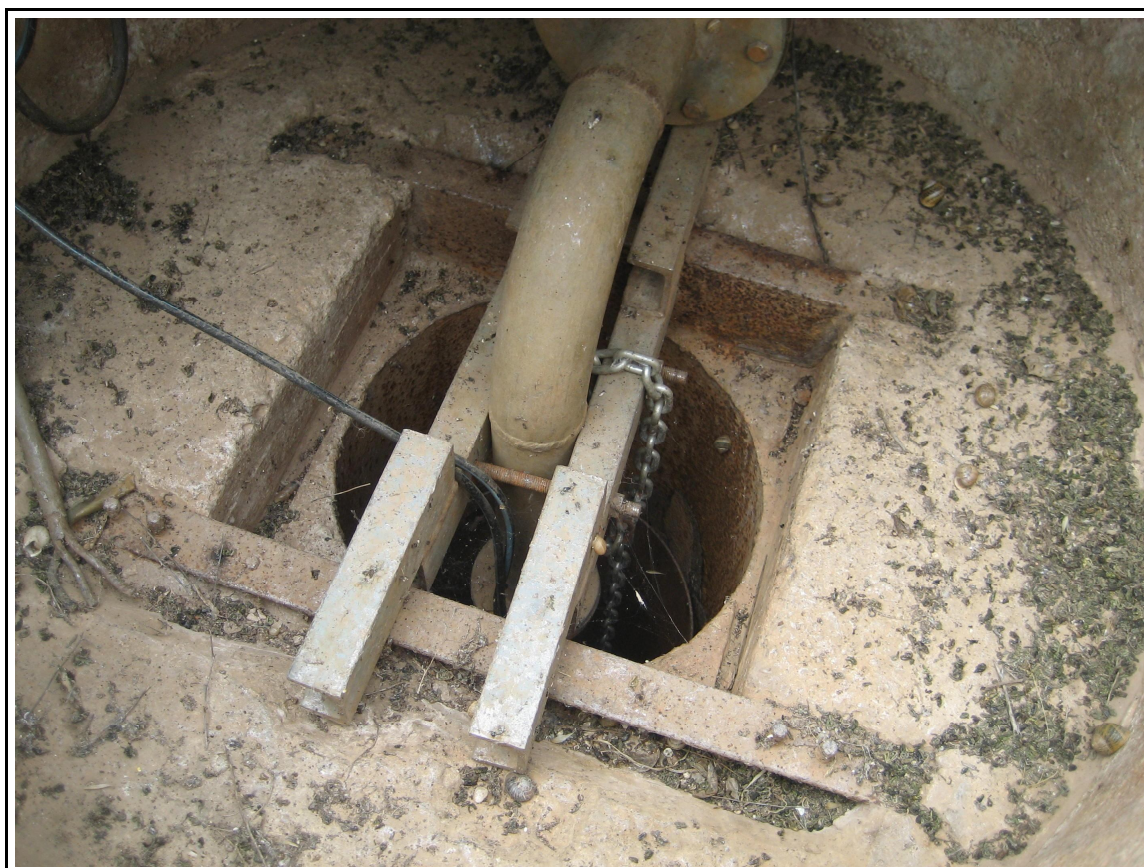
Vista detalle del pozo LLigem 1 (08/07/2008)
