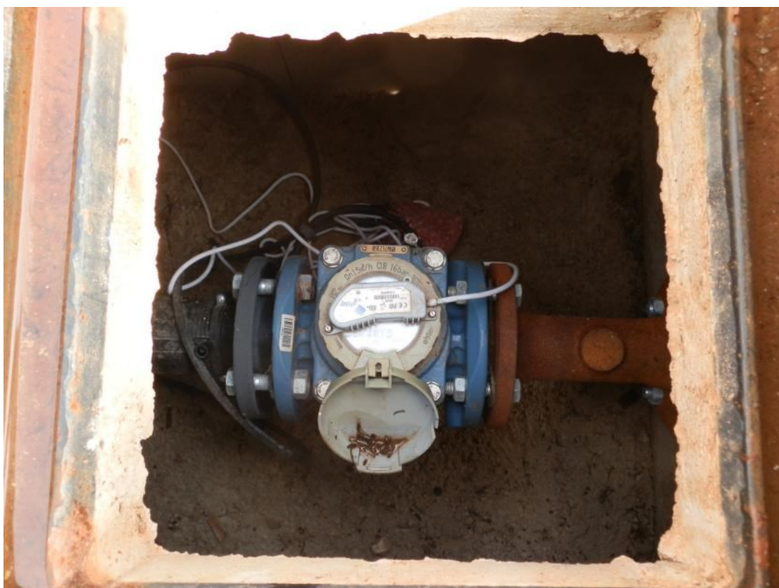
Foto 4. Contador control de caudal
