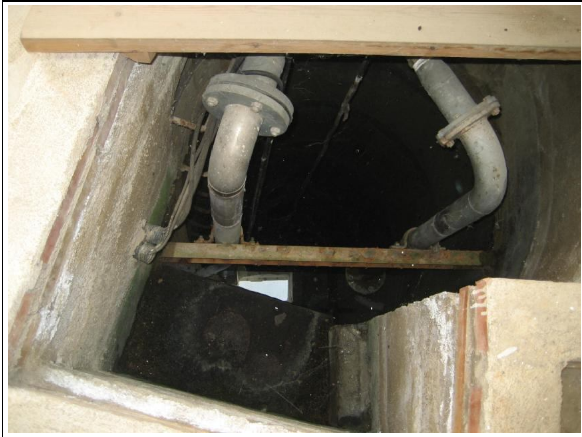
Bombeo del pozo - balsa al depósito (08/07/2008)
