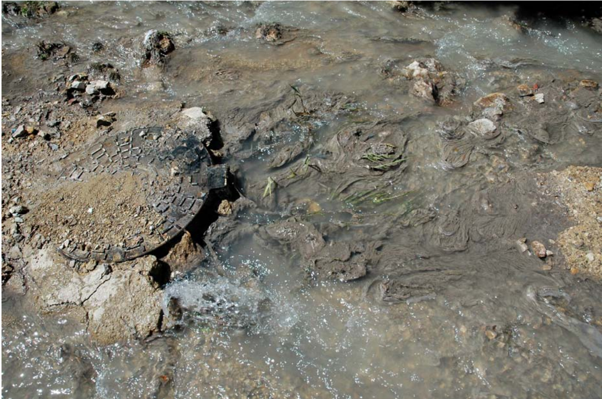
Fig. 91. Detalle de la suciedad junto al agua proveniente del alcantarillado en el tramo de Ágreda (Nº 351) en el río Val.
