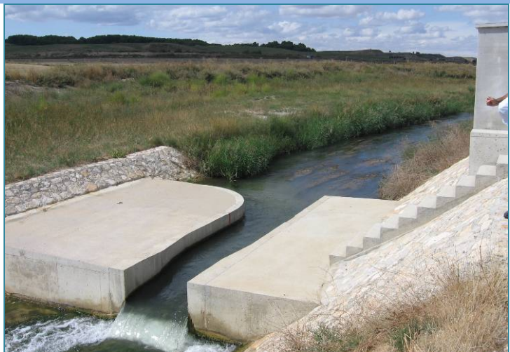
Estación de control de retornos de riego en Riegos del Alto Aragón
