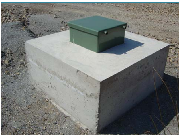
Aspecto final de un nuevo punto de la red de control piezométrico
