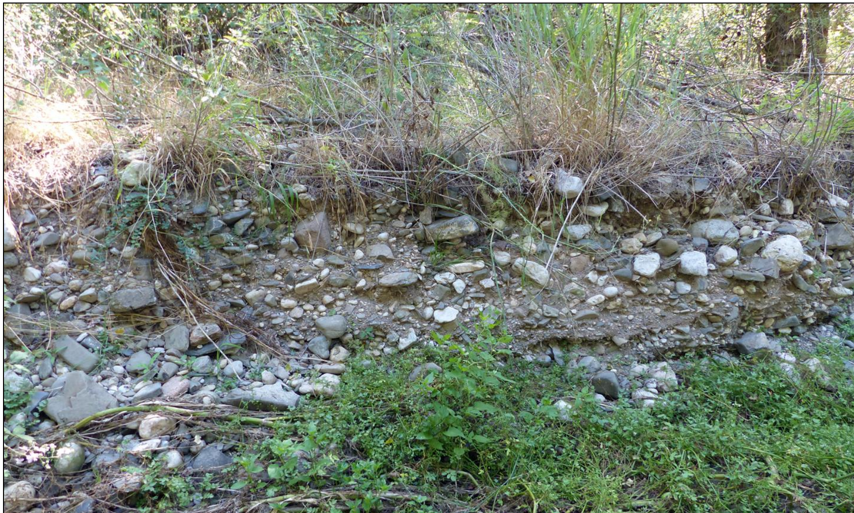
Imagen 3. Talud generado por el fenómeno de erosión en curva en el Río Siurana, aguas abajo de Poboleda. Se observa la heterogeneidad granulométrica y litológica de los sedimentos, característicamente orientados a lo largo de la dirección de la corriente.
