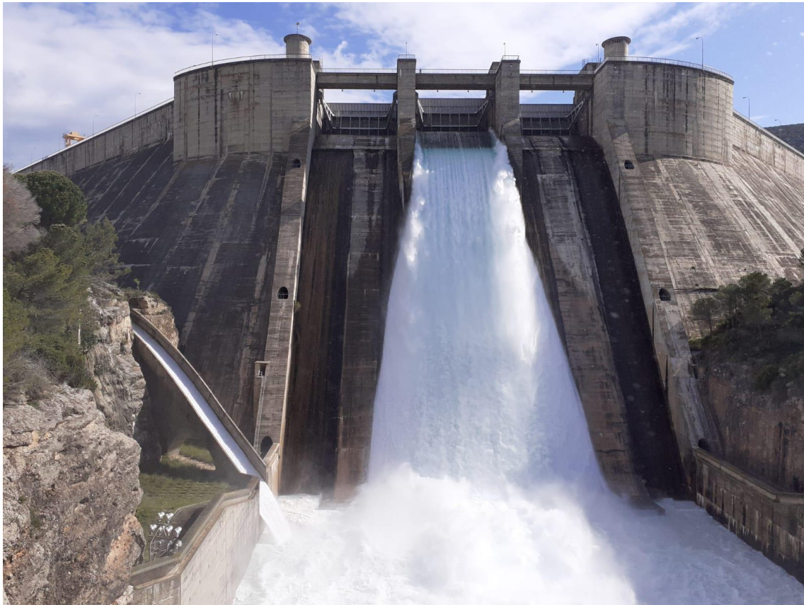
Aliviadero y trampolín de la presa de El Grado durante maniobras de apertura. Las nuevas componentes de los caudales ecológicos que se van a definir reforzarán la garantía ambiental de este tipo de operaciones.
